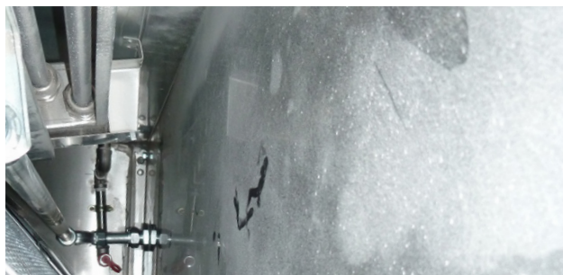
Vue de l'état intérieur d'un plénum d'extraction équipé de lampes UV-C après plusieurs semaines d'exploitation.
