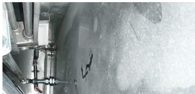
安装 UV-C 紫外线灯的排气室使用数周后的内部情况。
